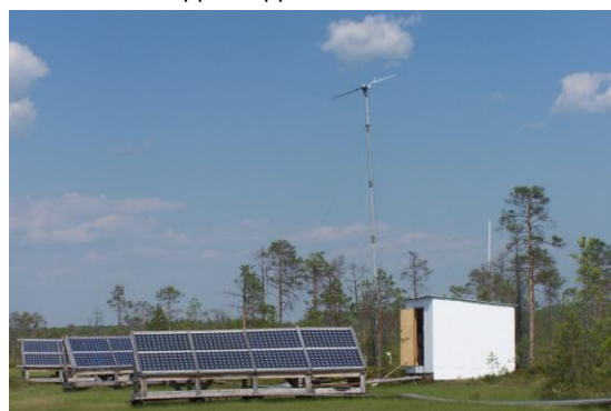
Ветроэнергетическая установка и солнечные батареи на верховом болоте, снабжающие энергией стационар Мухрино.
