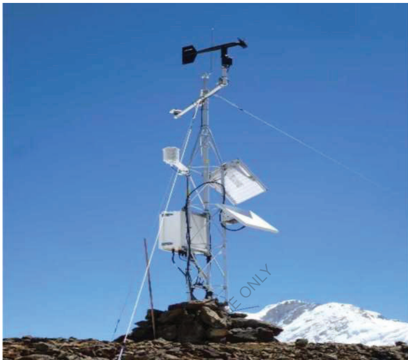
* Автоматическая станция "Campbell Sci.Co" 2015 (США).
